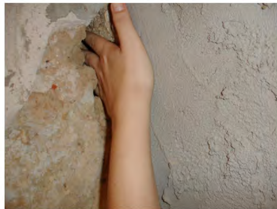
Figura 04 – Cobertura danificada da edificação. Fonte: Iphan-MT, 2013.
