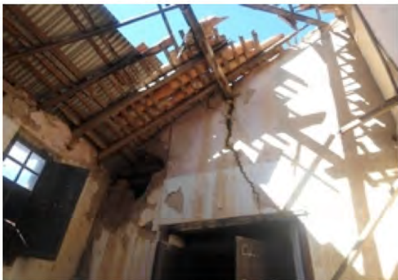
Figura 05 – Fissuras nos encontros de parede. Fonte: Iphan-MT, 2013.
